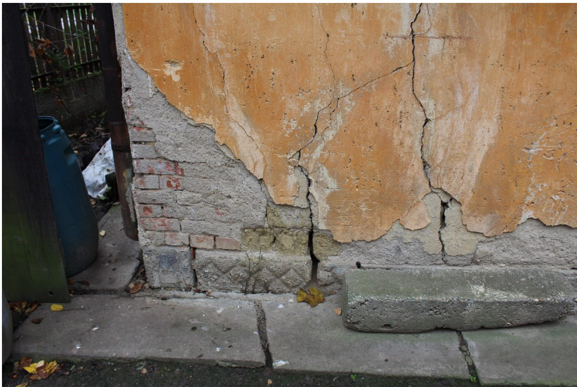
3. ábra – téglá oromfal elnyíródott a vályog hosszófaltól. Előregyártott beton lábazat!
