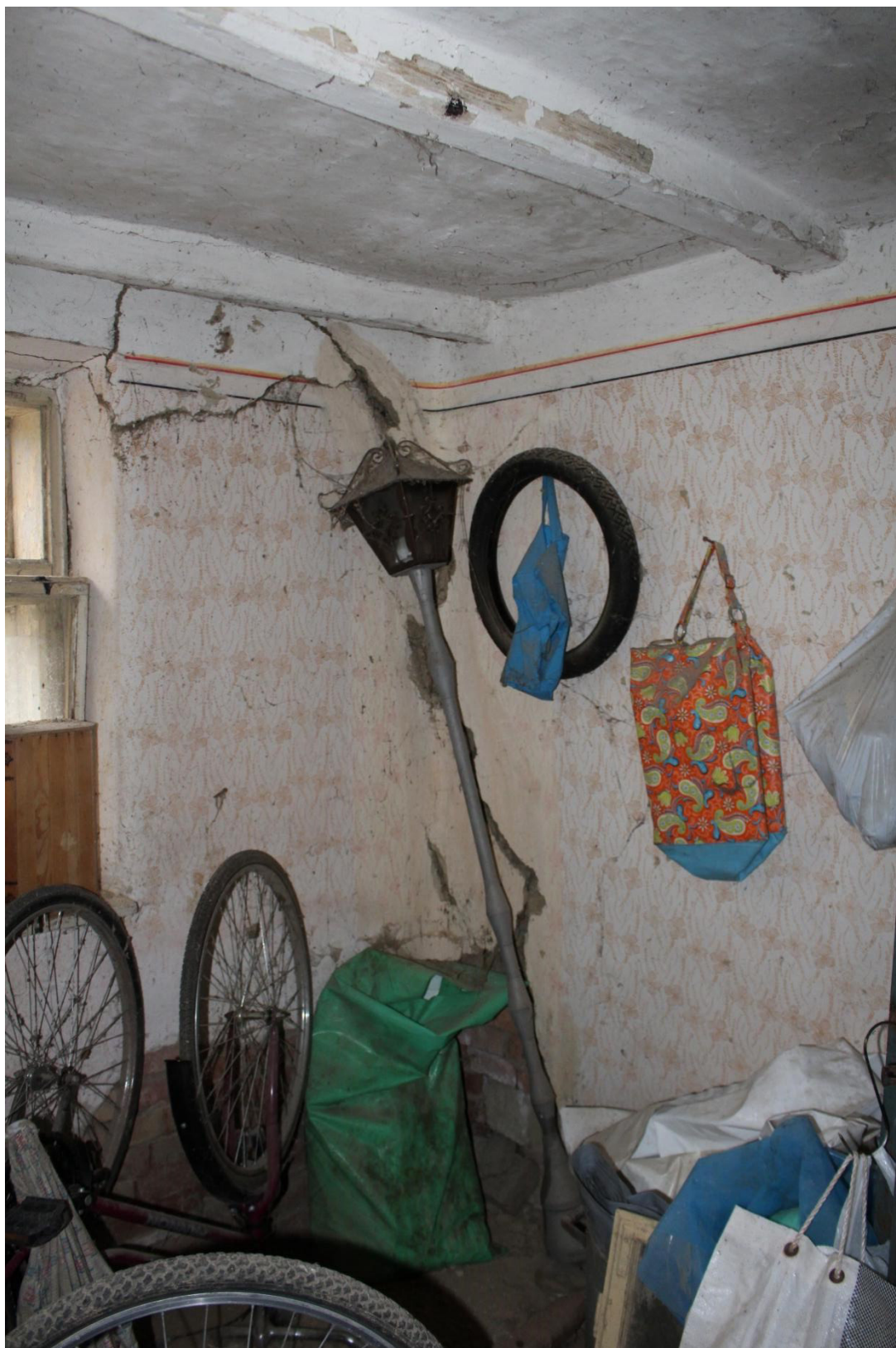
10. ábra – téglá homlokzati fal lenyíródott a vályogtégla hosszfőfalaktól
